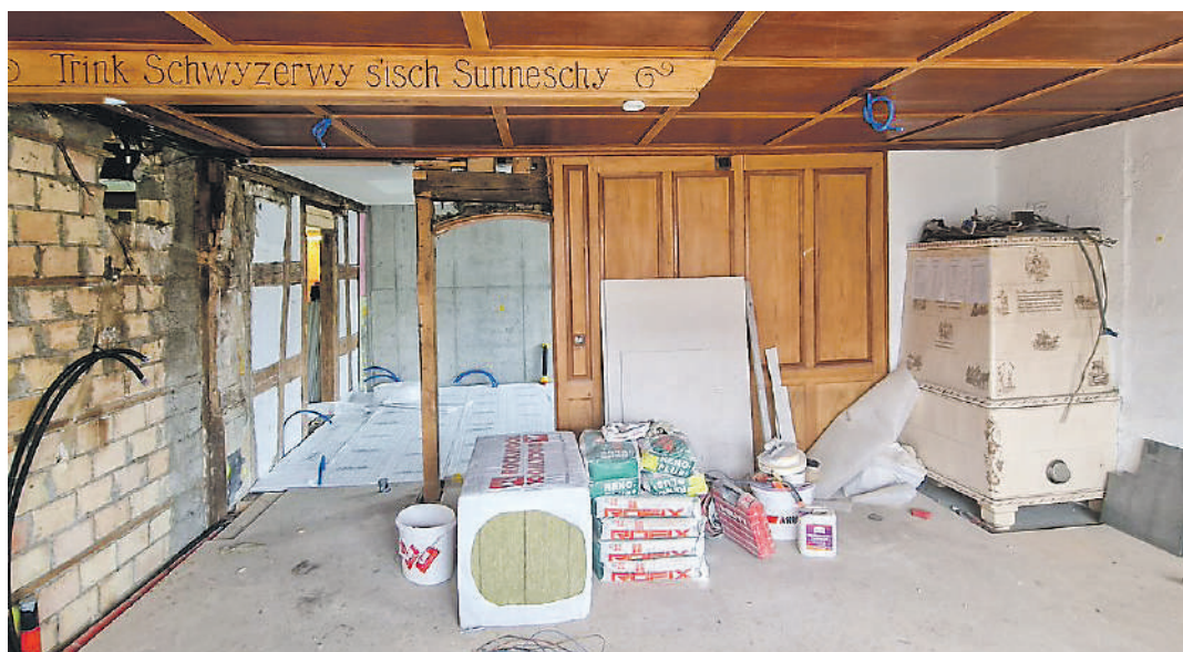
Im neuen alten Gastraum – hier mit Blick in die totalsanierte Küche – sind zwei Erinnerungsstücke erhalten geblieben: Der prächtige Kachelofen und der hölzerne «Werbebanner».
