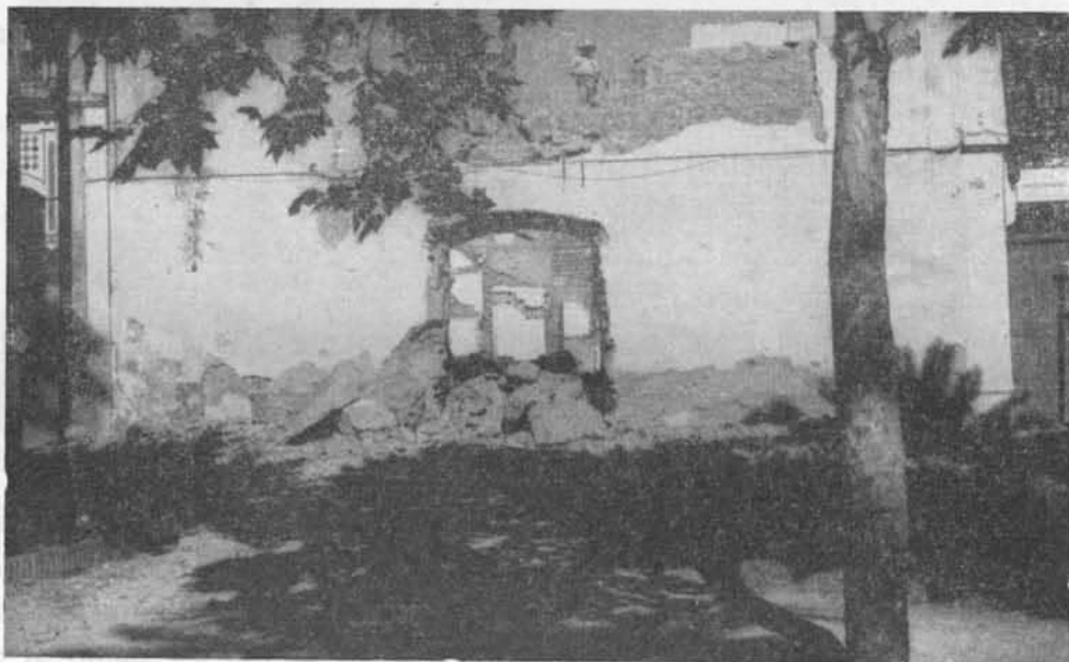
Salida al Paseo de la Victoria de la casa núm. 28 de la calle Tejón y Marín (Madera Baja), con la muralla terriza a medio demoler.
