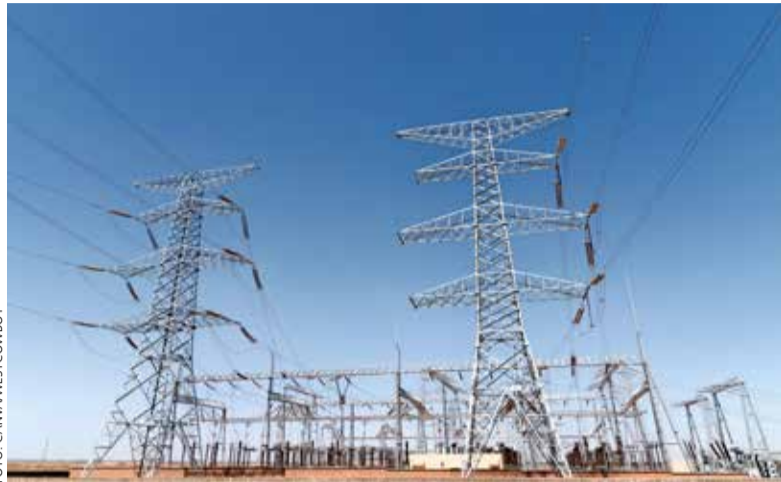
Hoogspanningsstation. Het elektriciteitsnetwerk heeft vaak te weinig capaciteit. Dan moeten voedingsmiddelenproducenten gas blijven verstoken.
