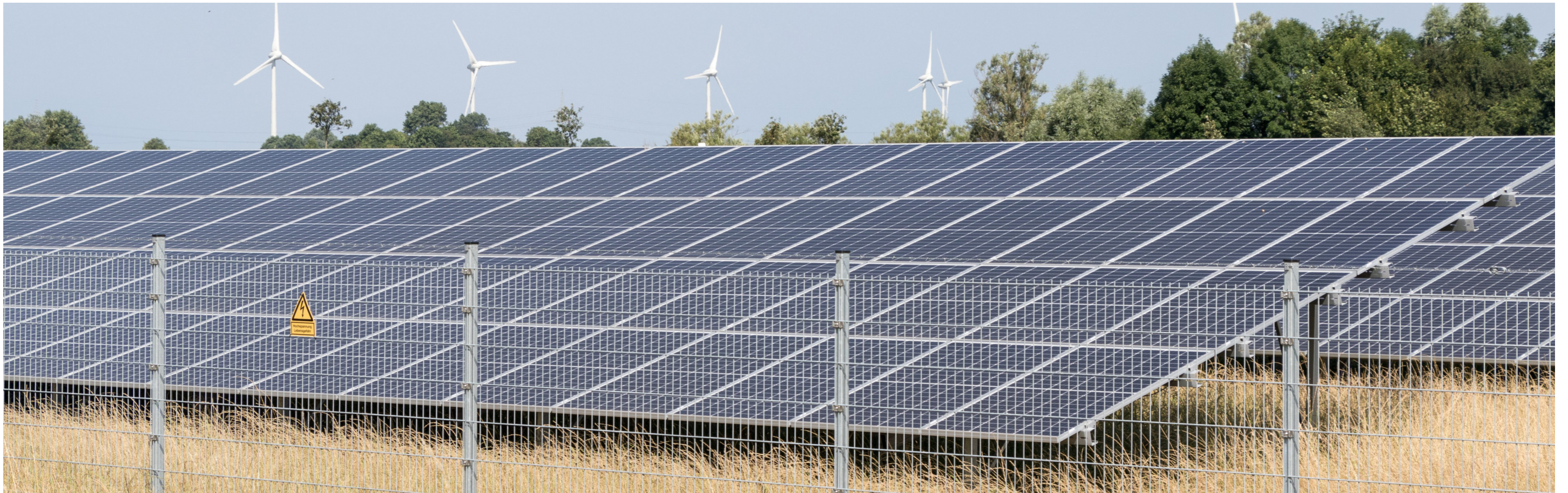
Freiflächen-Photovoltaik-Anlage Tating (Foto: Friedhelm Koss)
