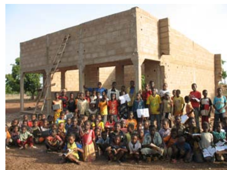
Salle de classe inachevée
