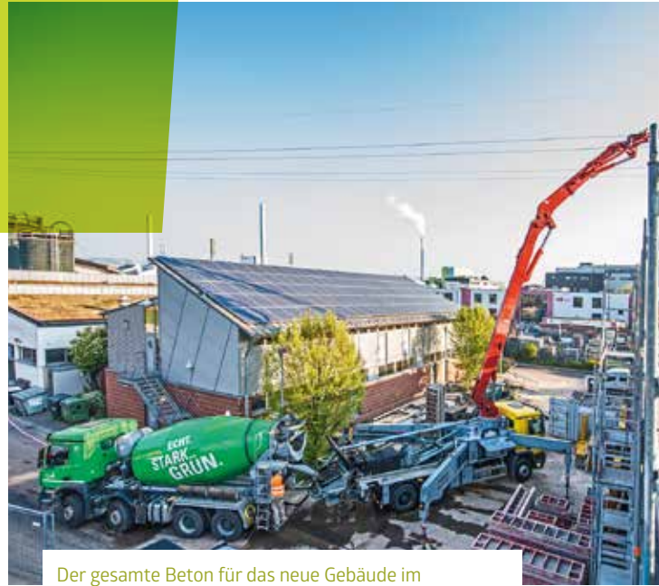
Der gesamte Beton für das neue Gebäude im Betriebshof 2 wurde von Heidelberger Beton im nahen Betonwerk Ingelheim produziert.
