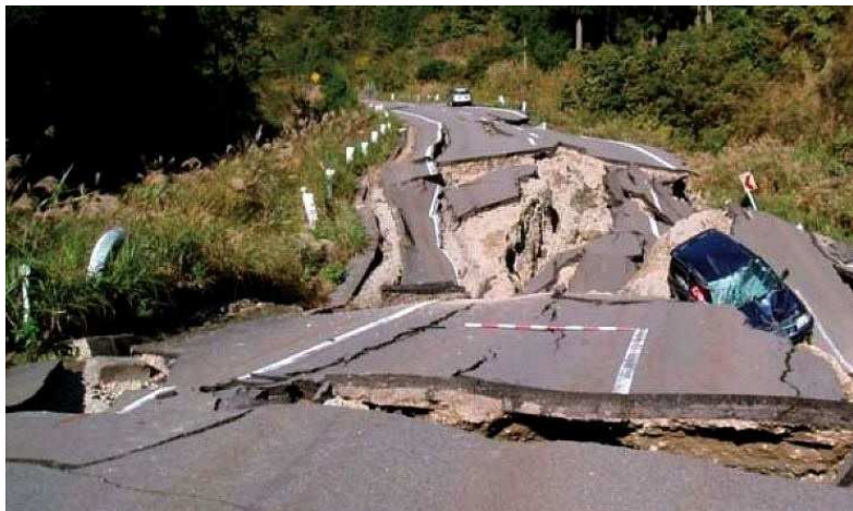
中越地震における道路損傷 (R252) 10
