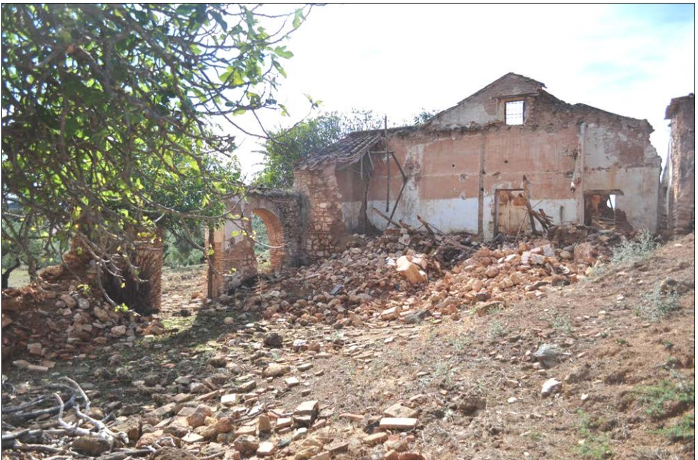
Fig. 3. Acceso por su cara este. Compárese con la Figura 2 el arruinamiento de la portada (2012-10-03).
