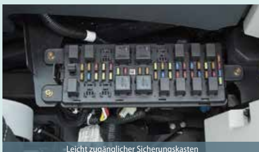
Leicht zugänglicher Sicherungskasten
