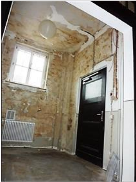
Abb. 9: Juni 2018 – Wasserschaden nach Abtrocknung
