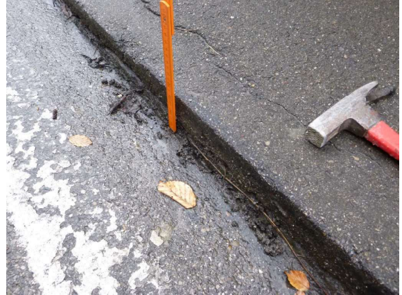
7524527_2016H_19-LÄNGSFUGE FAHRBAHN RAND SCHADHAFT
