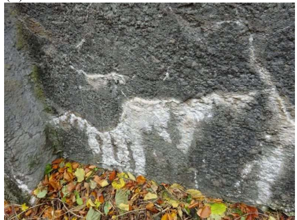
HP2021_SPRITZBETONSCHALE RISS MIT AUSSINTERUNG
