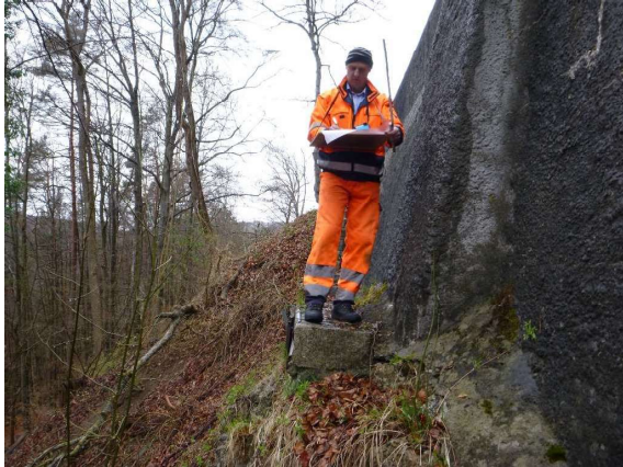
7524527_2016H_14-FEHLLENDE ABSTURZSICHERUNG NOTGEHWEG
