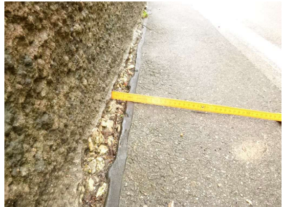
7524527_2016H_22-SPRITZBETONSCHALE BRÜSTUNGSFUSS SCHADHAFT
