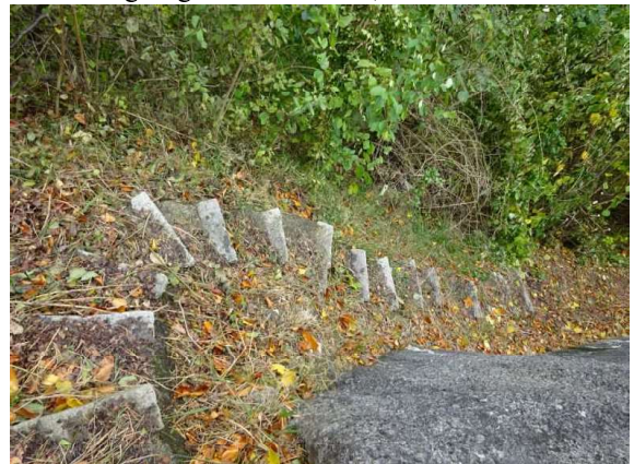
HP2021_BÖSCHUNGSTREPPE NICHT FACHGERECHT
