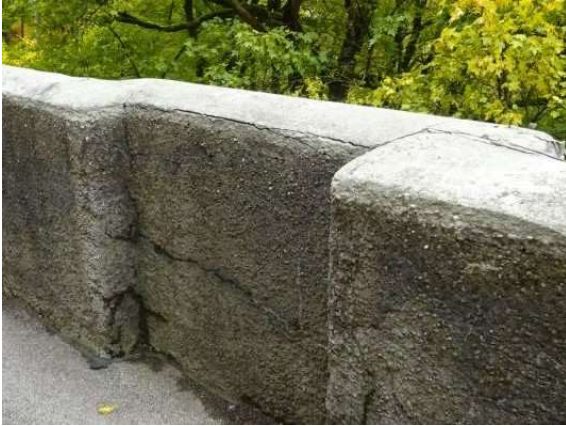
HP2021_RISSE IN BRÜSTUNG
