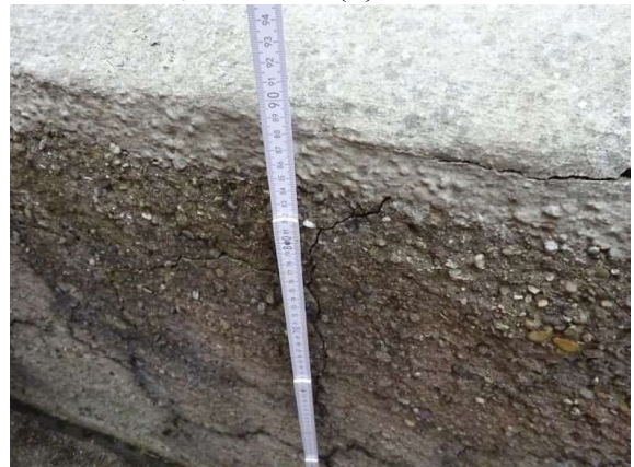
HP2021_BRÜSTUNGSHÖHE ZU GERING
