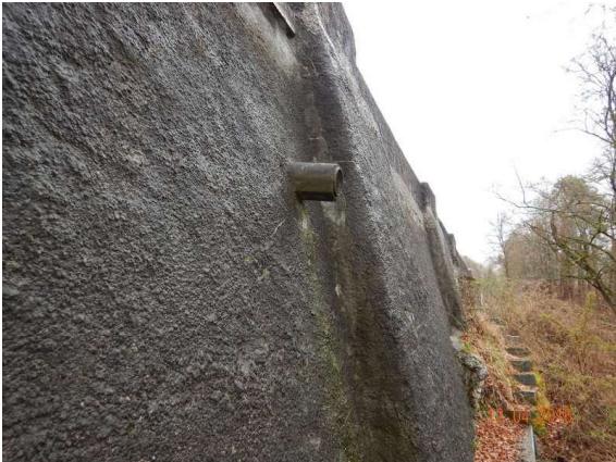
7524527_2016H_24-ENTWÄSSERUNGSROHR ZU KURZ
