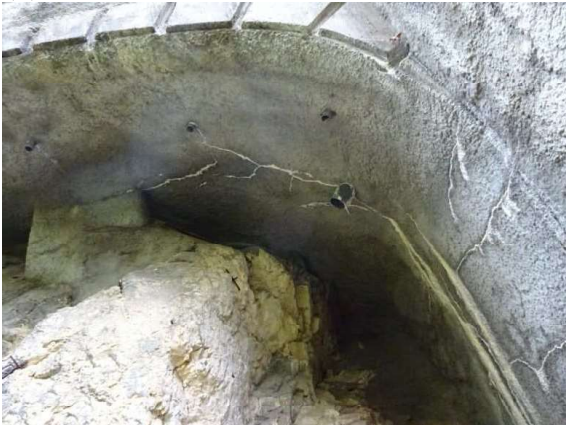
HP2021_GEWÖLBEWANDUNG RISSE MIT AUSSINTERUNGEN
