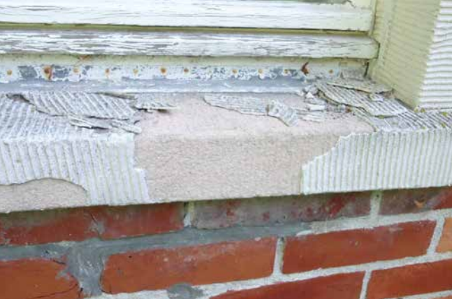
Asbesthaltige Spachtelung Fenstergewände
