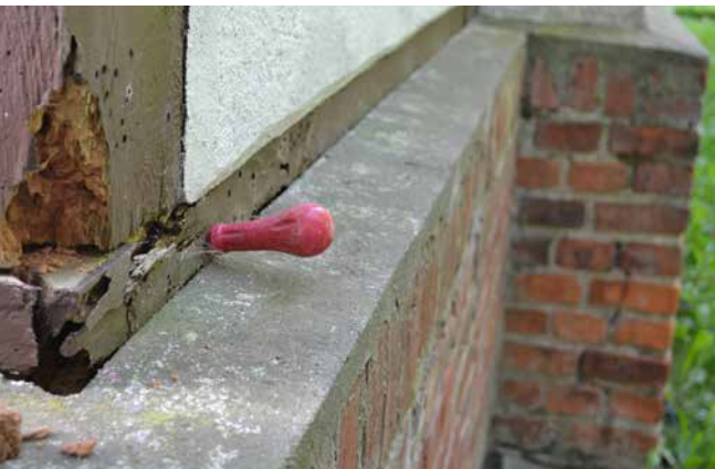
Verrottete Fachwerkschwelle Ostveranda
