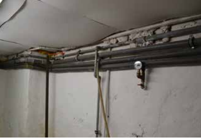
Wasser- und Heizungsleitungen
