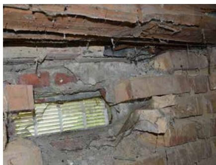
Halbsteinige Kelleraußenwand mit Verblendmauerwerk, aussandende Fugen
