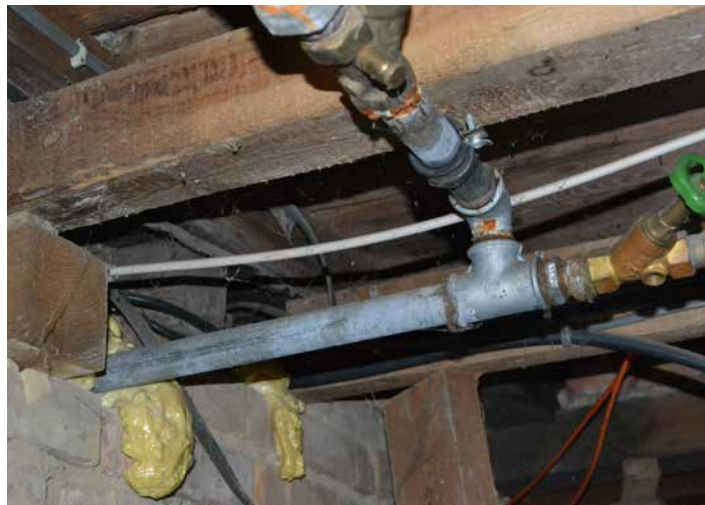
Materialmix ungedämmte Wasserleitungen
