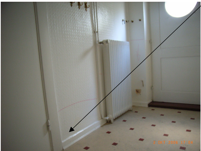
P:\Eigene Gutachten-Versuche\Kvarnström\Ordner für Fotoanlage IFR\2IFRRIMG8405.JPG
