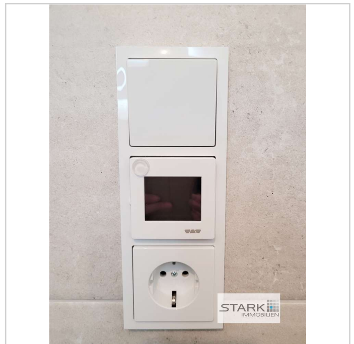
Fußbodenheizung im Bad
