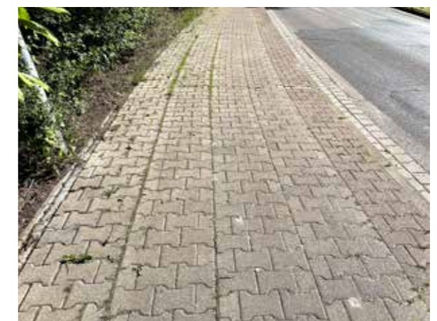
Abb. Zustand Gehweg an der Kreisstraße
