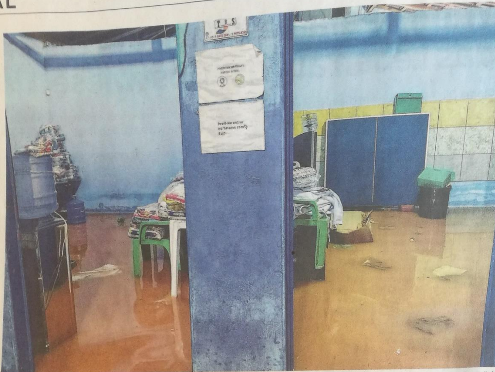
Der Regen hat großen Schaden angerichtet. Dach und Fassade sind betroffen, und die Elektrik wird derzeit geprüft.
