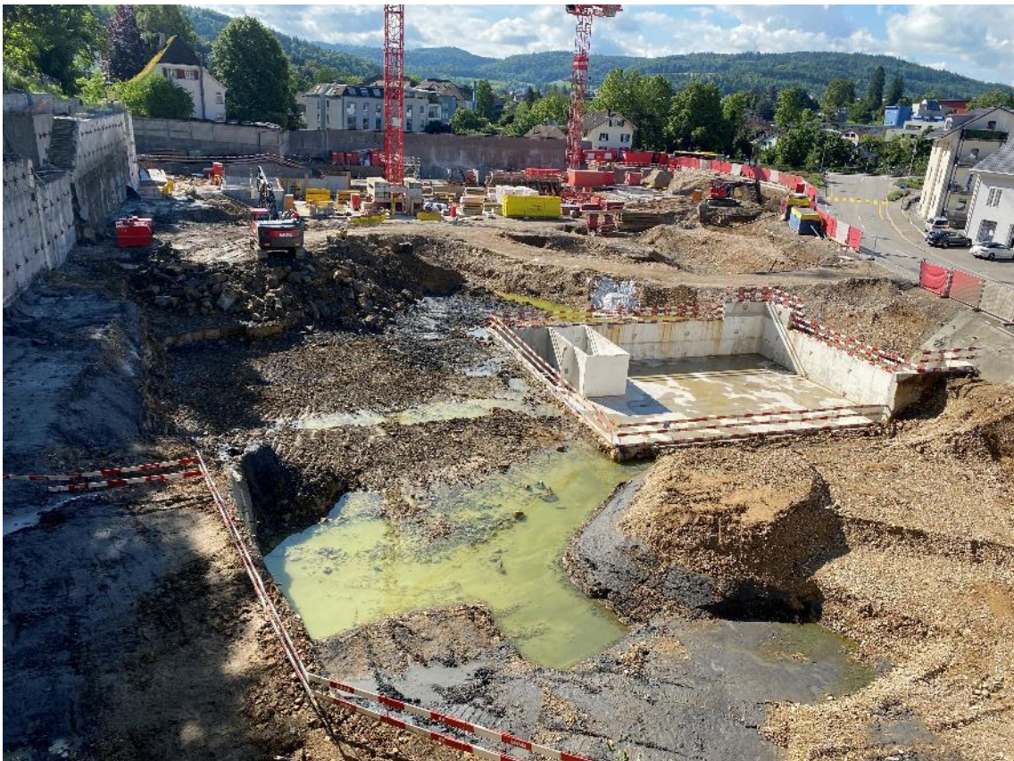
24. Mai 2024: Neben den Resten des Verwaltungsgebäudes bildet sich ein veritabler See
