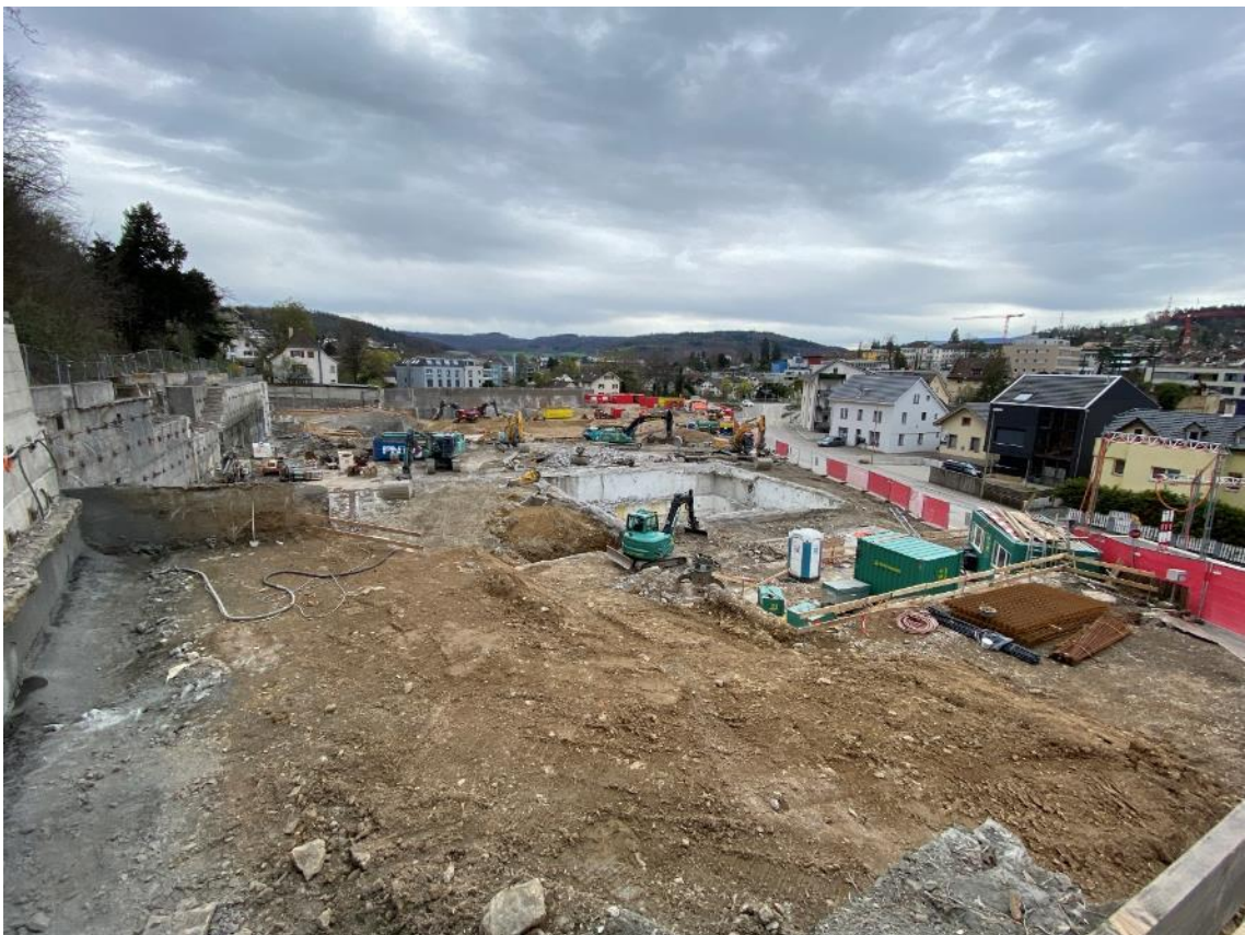
29. März: Nun ist nur noch der Keller sichtbar. Erzenberg ist Geschichte. Es wird der Hang gesichert und bereits mit den Vorarbeiten begonnen.
