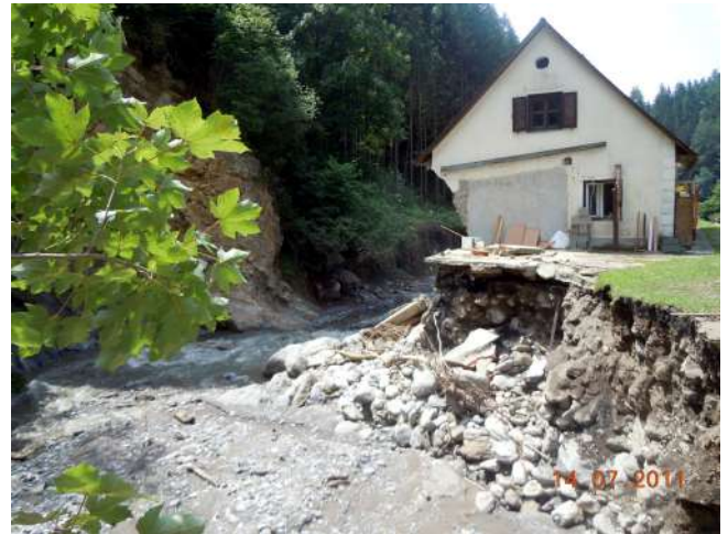
Abb. 4: Hochwasserschaden am Wölzerbach 2011; Wasserwirtschaft Land Steiermark
