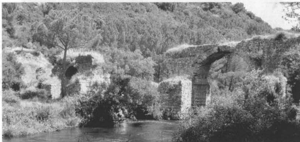
Estado de deterioro en el que se encuentra actualmente el puente de los Arenales, levantado sobre el río Guadiato.
