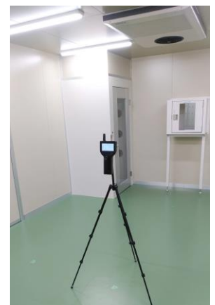
クリーンルーム施工例
