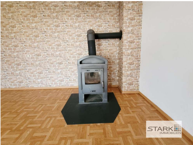
DG Holzofen Wohnzimmer
