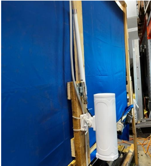
Abbildung 13: Antenne und LoRaWAN-Gateway (Quelle: eigene Aufnahme 24.05.2024)
