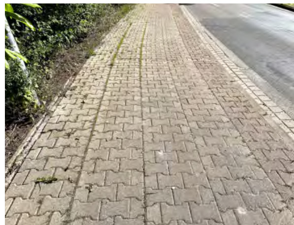
Abb. 139 Zustand Gehweg an der Kreisstraße
