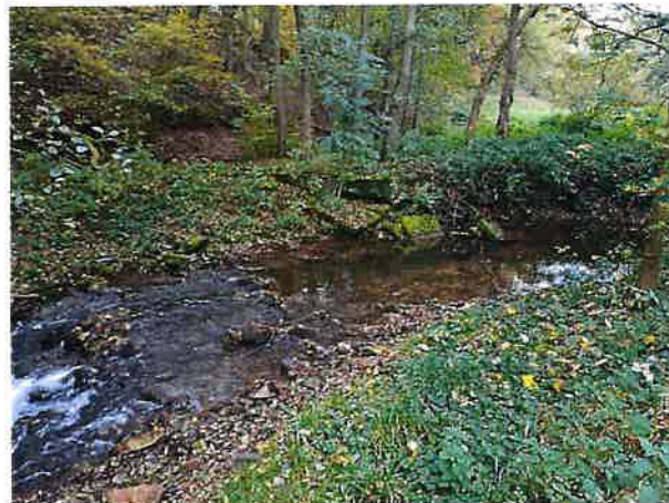
Blick auf abgängiges Bauwerk
