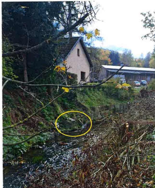
Kantenstein wurde nachträglich aufgesetzt
