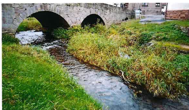
Anlandungen im Unterstrom der Bogenbrücke
