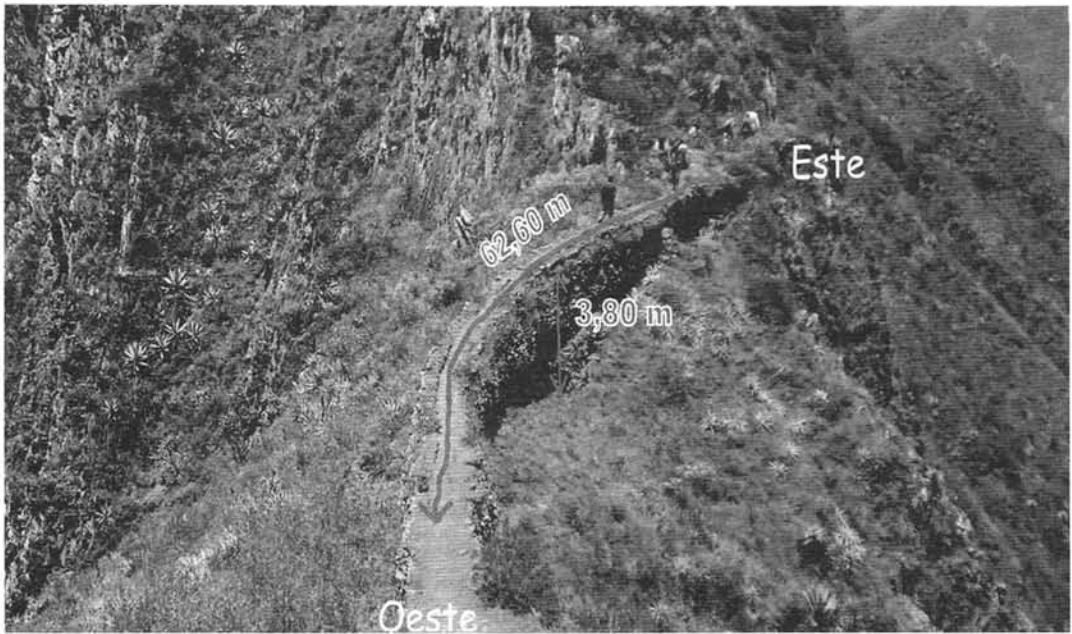
Figura 7. Longitud y altura máxima del muro en el tramo de canal estudiado.
