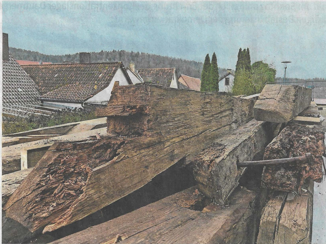
Eindringendes Wasser hat den Holzbalken des Gebäudes aus dem Jahr 1847 schwer zugesetzt. Der Zimmerer muss alle Register seines handwerklichen Könnens ziehen.
