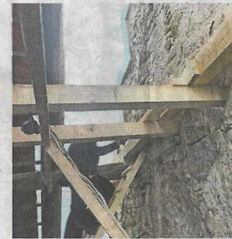
Eine Hilfskonstruktion stützt das Gemäuer.
