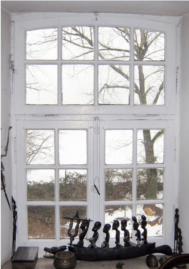
12. Baskülever- schluss der zwei Flügel im unteren Bereich des Fens- ters. Foto: Werner von Schorlemer, LVR-ADR.
