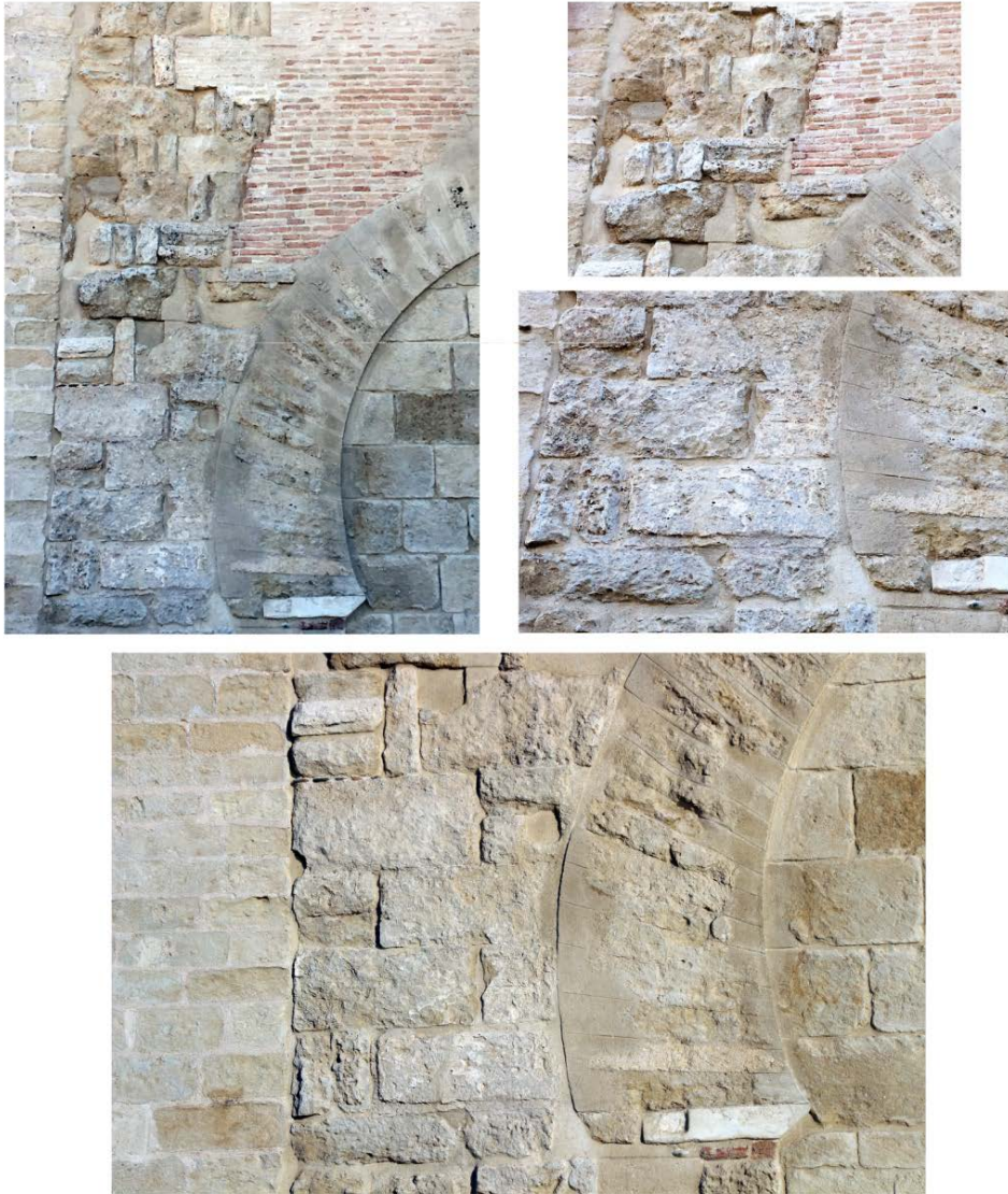
Figura 8.- Detalles del aparejo a soga y tizón, con huellas de sillares almohadillados, correspondientes a la fábrica de la puerta omeya.
