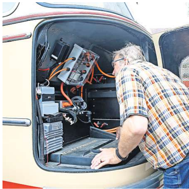
Knifflige Programmierung: Die Steuerelektronik und das Bordnetz neben den Akkus (rechts) im Heck des umgebauten Setra-Busses.
