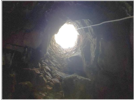
Fig. 5. Encañado del pozo n.º 2
