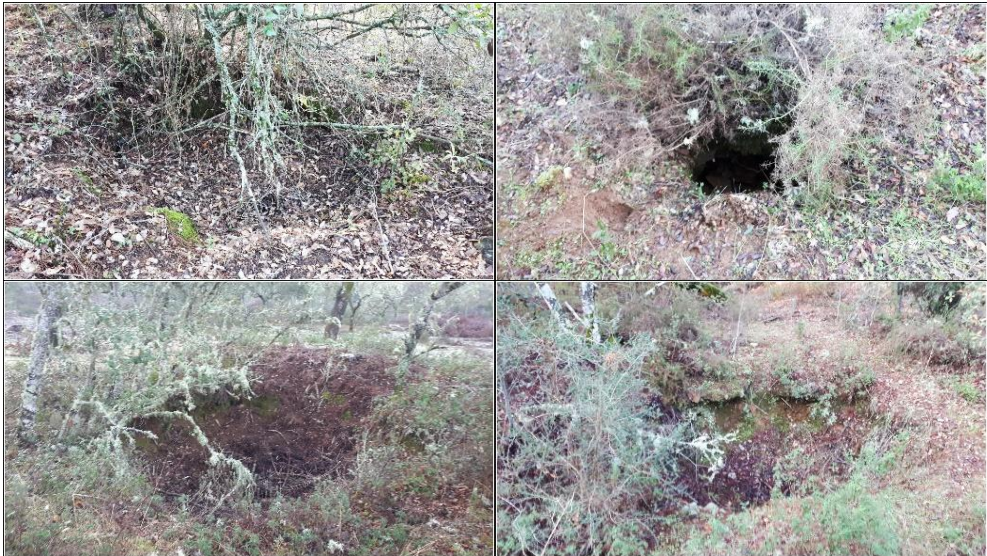
Fig. 8. Hundimientos indicadores de la traza del acueducto
