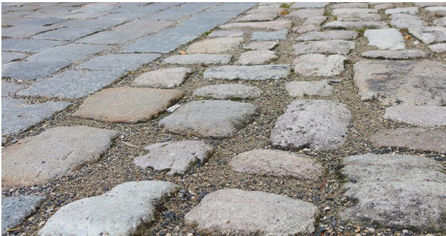
Vorher: große Pflastersteine mit großen Fugen (Quelle: Bayern barrierefrei)
