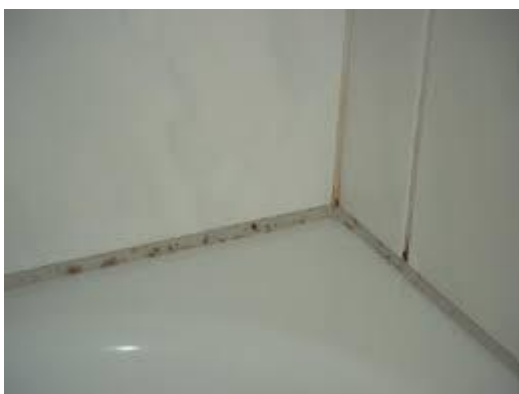
Figure 5: Douche du logement du dessus ( https://www.raffa-fugenabdichtungen.ch )
