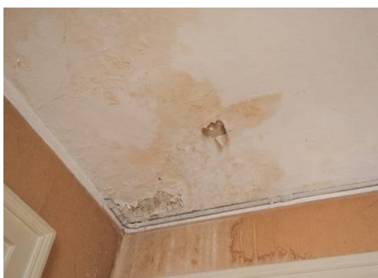
Figure 4: Plafond du logement du dessous ( https://de.123rf.com/lizenzfreie-bilder/wasserschaden )
