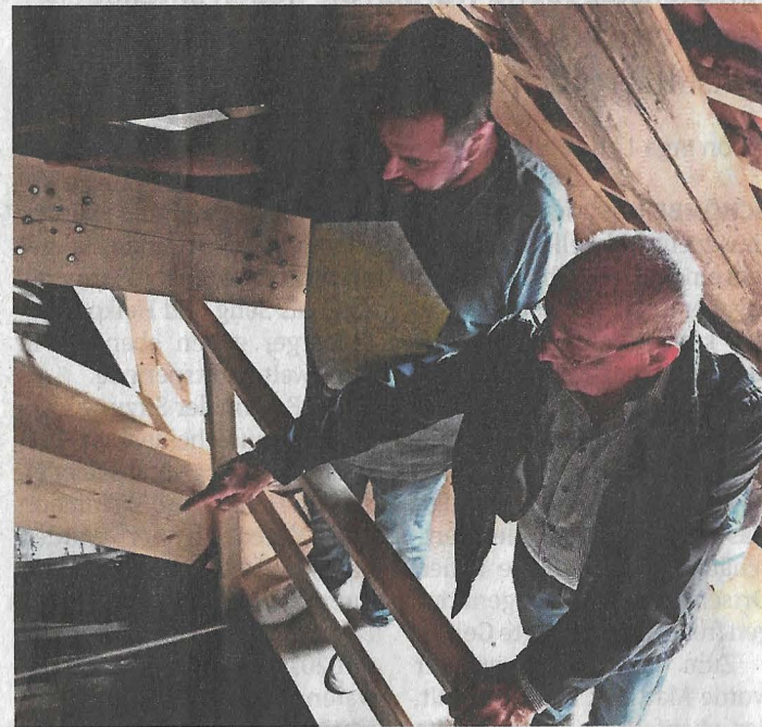
Jens Schlehe (links) erläutert den Fortschritt der Sanierungsarbeiten in der Heiligenzimmerner Kirche.
