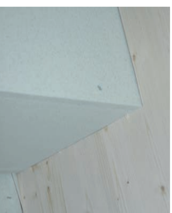
Deckendurchbruch ohne Sicherheitsabstand (Zulassung Abgasanlage beachten)
