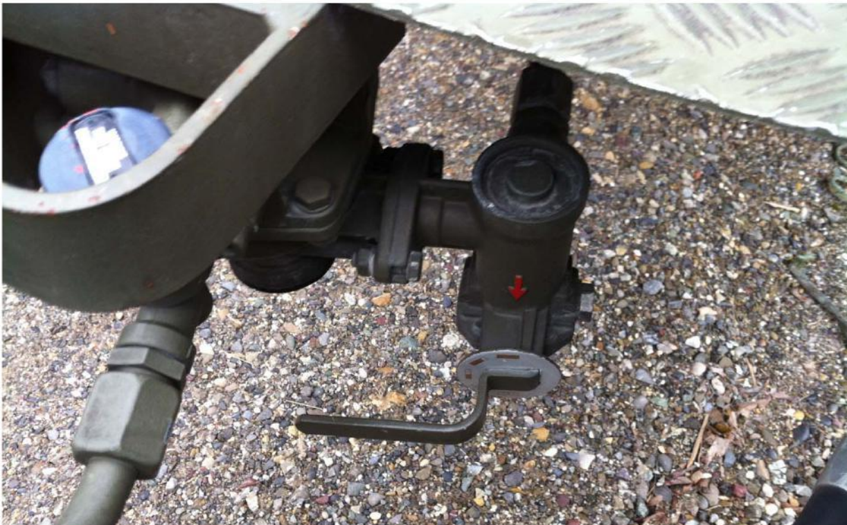
Bremskraftregler (aktuell eingestellt auf Volllast)
