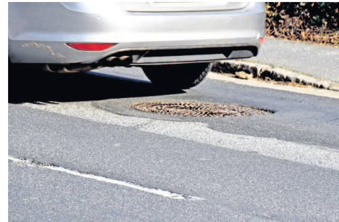
Für Autofahrerinnen und Autofahrer ein Ärgernis, für Anwohnerinnen und Anwohner eine weitere Lärmquelle. Gullideckel, welche in den Asphalt absacken.
