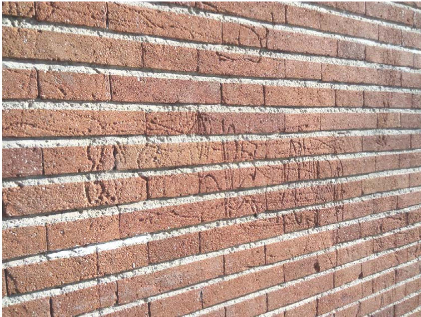
Fig. 6. Huellas de las raíces aéreas de la hiedra, Hedera hélix , sobre una pared de ladrillo
