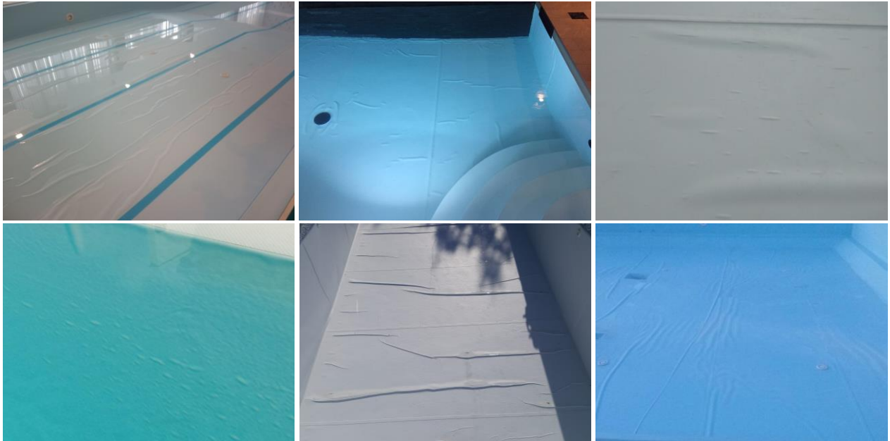
Faltenbildung bei Schwimmbadbahnen auf dem Boden und Wänden
