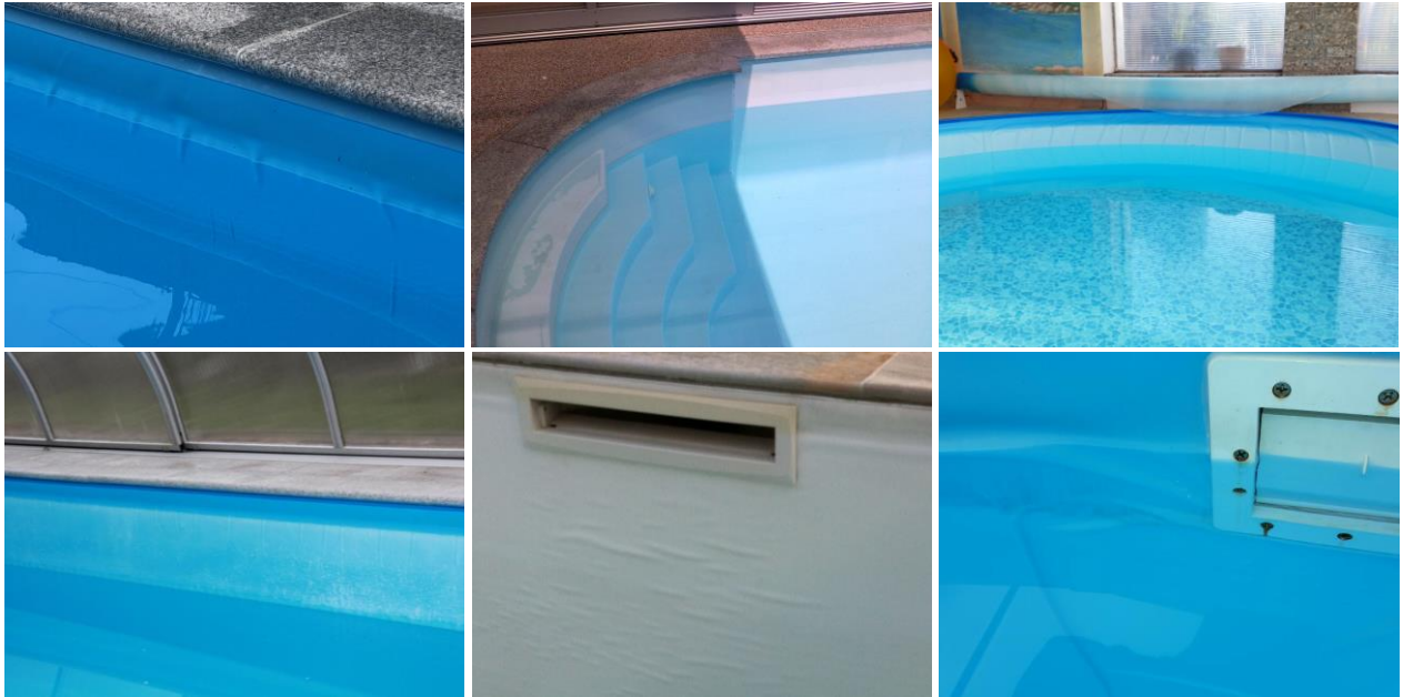
Falten und Ausbleichen bei Schwimmbadfolien und gewebeverstärkten Schwimmbadbahnen
