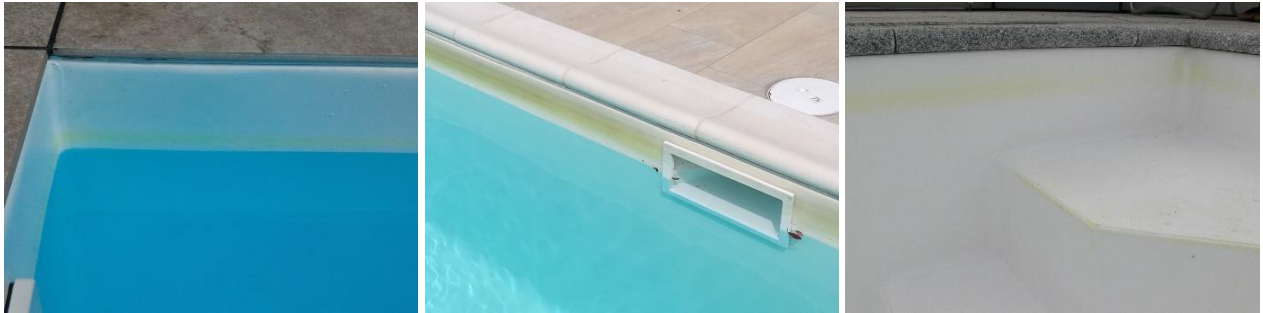
Verfärbte Wasserlinie bei PVC-Abdichtungsbahnen
