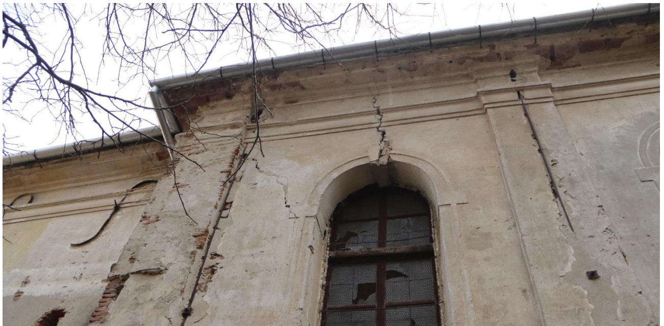
Fig.14. Fisuri verticale în zona superioară a ferestrelor de pe elevația nordică a navei
