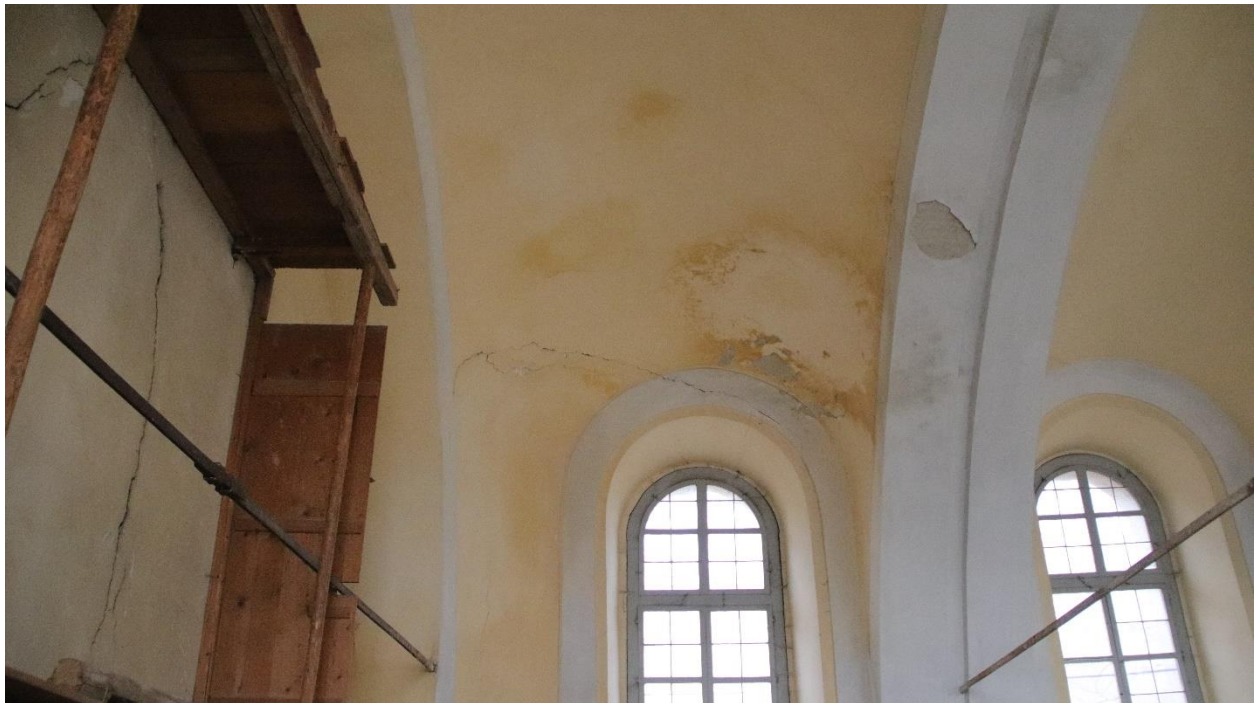
Fig.24.Fisuri și puncte de umezeală în zona ultimei ferestre a extremității vestice a elevației nordice, unde punctele de prelingere a apei au dus la pătrata zugrăvelii
