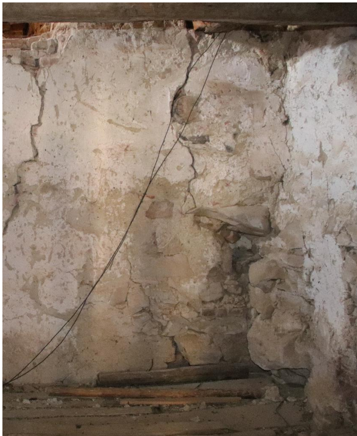
Fig.42. Degradări ale tencuielii turnului-clopotniță
