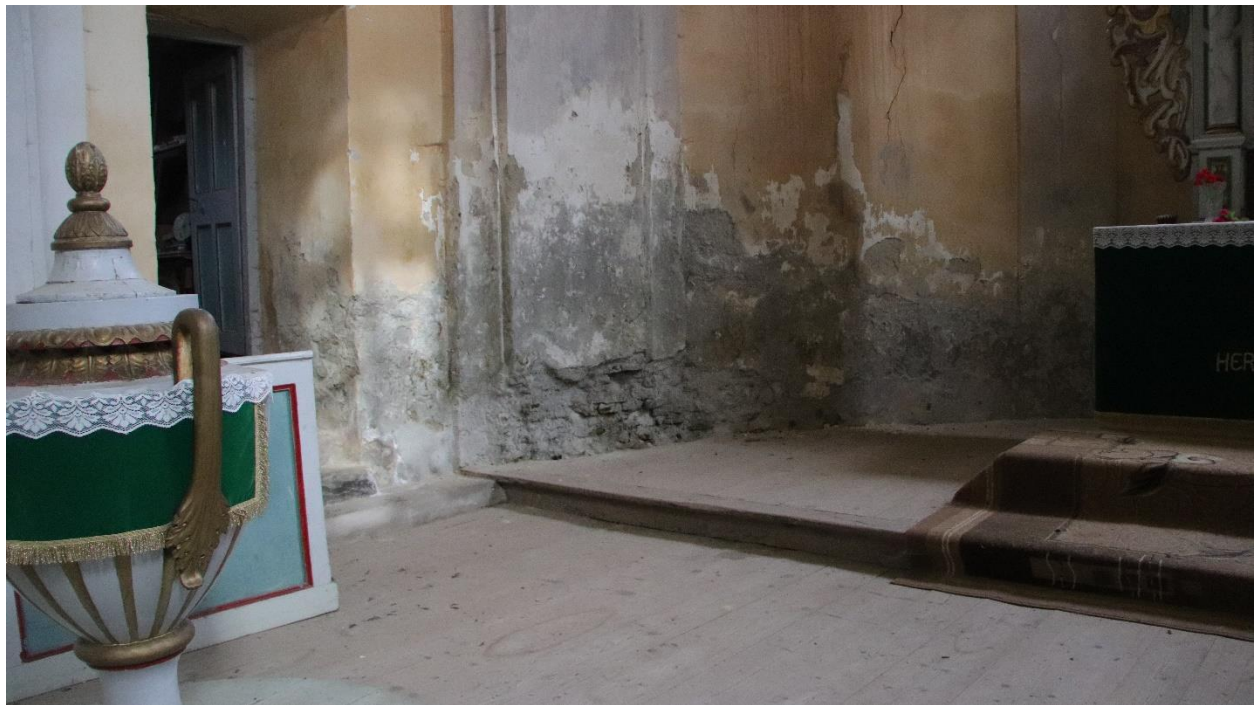
Fig.32.Degradări ale soclului în zona altarului
