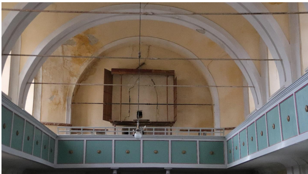
Fig.28.În extremitatea sudică a elevației vestice, la baza arcului baroc, se regăsesc urme de umiditate cauzate de prelingeri ale apei, care au dus la pătarea zugrăvelii interioare
