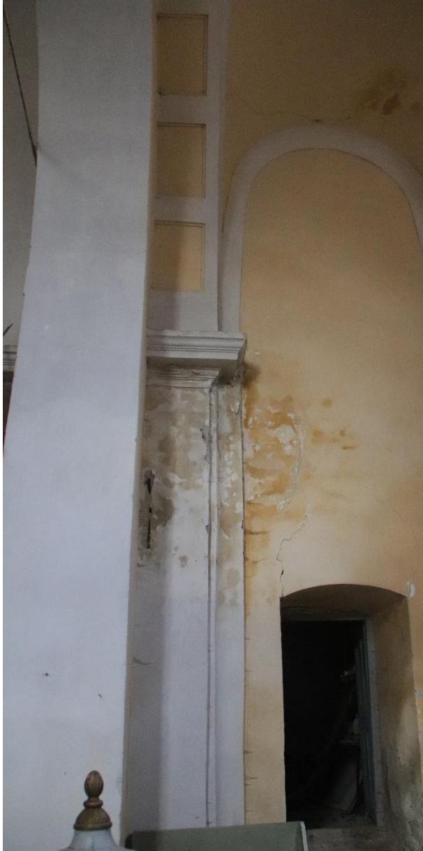
Fig.35. Degradări în zona pilastrului nordic al altarului
