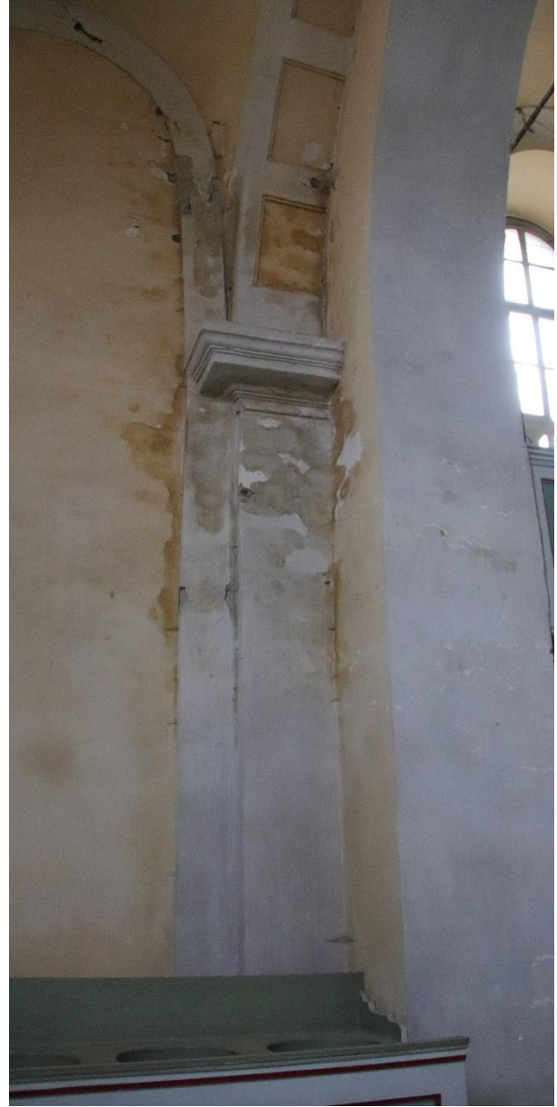
Fig.36. Degradări în zona pilastrului sudic al altarului
