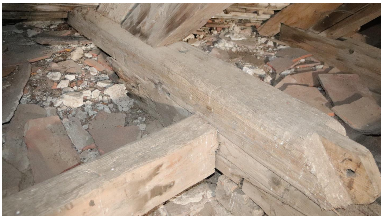
Fig.40. Degradări specifice în zona elementelor de șarpantă, la nivelul corzilor
