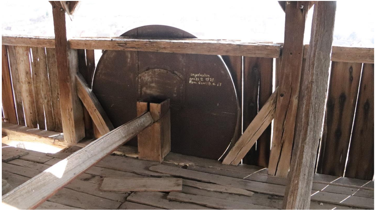
Fig.48. Degradări ale elementelor din jurul cadranului ceasului din turn
