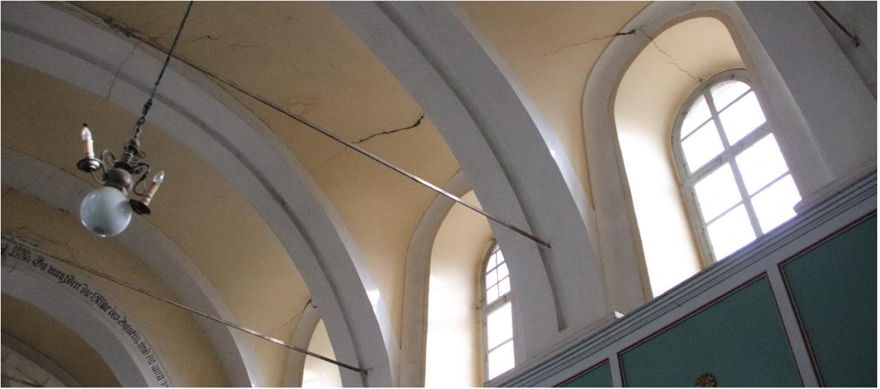
Fig.25.Fisuri verticale la partea superioară a primelor 3 registre de ferestre dinspre altar
