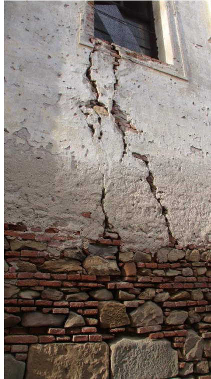
Fig.12. Fisuri verticale în zona inferioară a ferestrelor altarului
