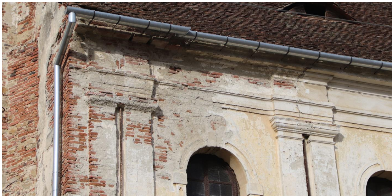
Fig.8.Imagine a cornișei elevației sudice dinspre turn. Se pot observa degradările cauzate de apele meteorice și evacuarea improprie a acestora, precum și introducerea ineficientă a jgheabului și burlanului.
