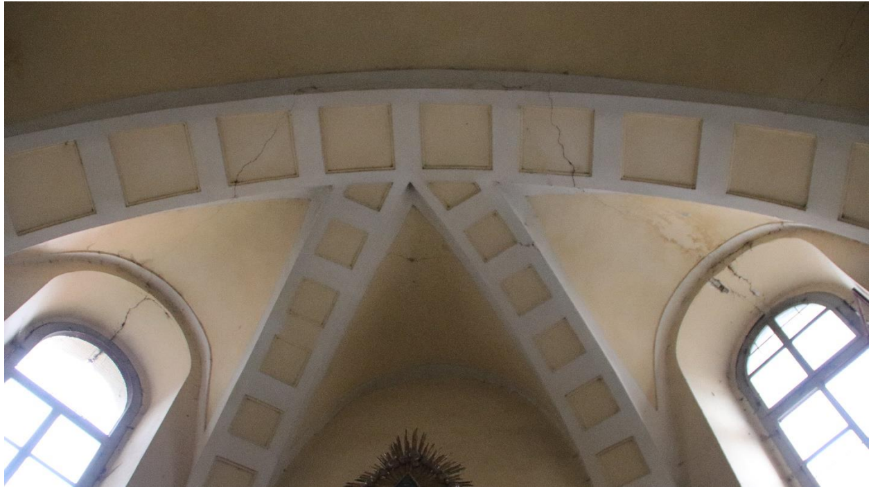
Fig.31. Fisuri în zona ferestrelor altarului
