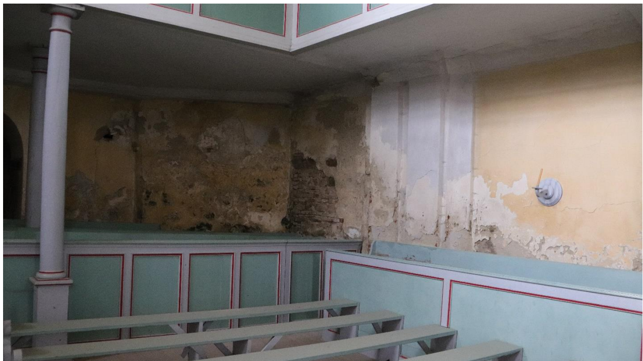
Fig.34. Degradări în coltul dinspre nord-vest
