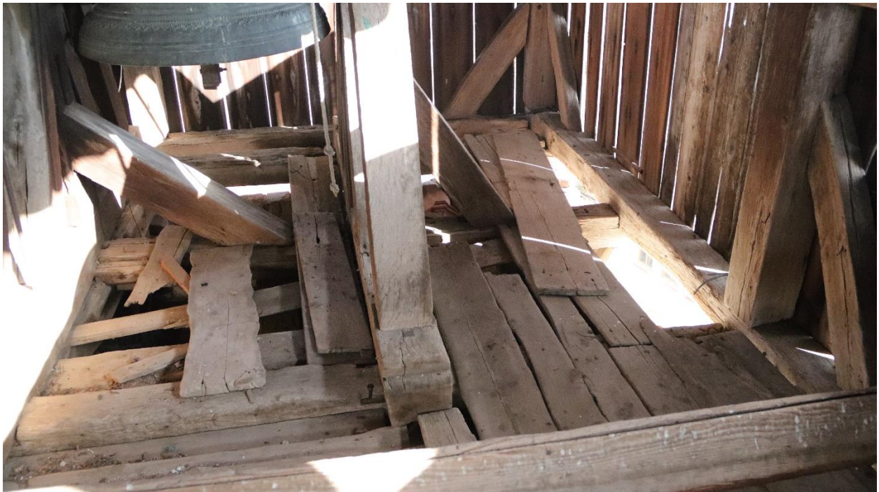
Fig.47. Dușumeaua ultimului nivel al turnului, subdimensionată
