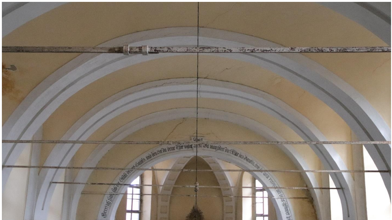
Fig.30. Fisurile din zona arcelor baroce ale navei
