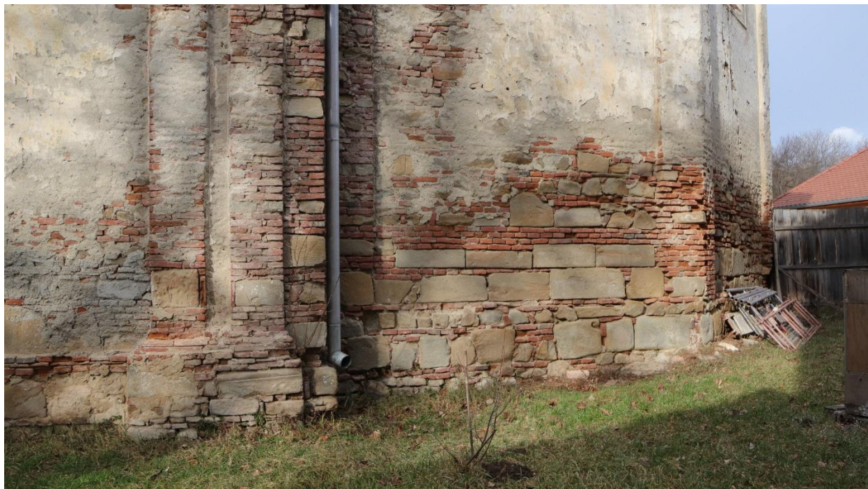
Fig.7.Imagine a soclului dinspre altar. Se pot observa degradările specifice la soclu datorate infiltrațiilor și umezelii
