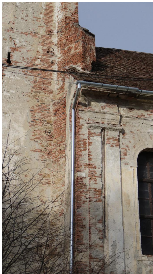
Fig.10. Întersecția dintre turnul clopotniță și nava bisericii, se observă degradări la nivelul coloanei adosate, a contrafortului și a cornișei bisericii.
