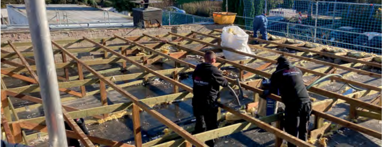
Die alte Dachhaut wurde entfernt, eine neue Isolierung und Dachhaut wurden eingebaut.
