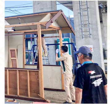
トンネル工事の西松建設さんにも設営にご協力頂きました。
