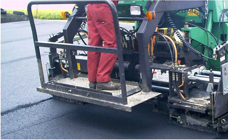
Maschinell aufgetragener Asphaltbeton: Solch eine Schutzschicht sichert eine längere Haltbarkeit des Silosbodens.
