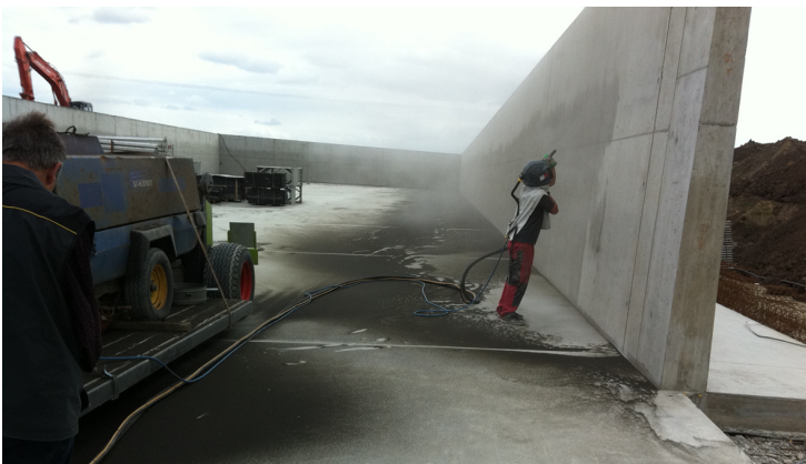
Vor dem Auftragen eines Schutzanstrichs muss der Untergrund gründlich gereinigt werden. Fotos: Reith
