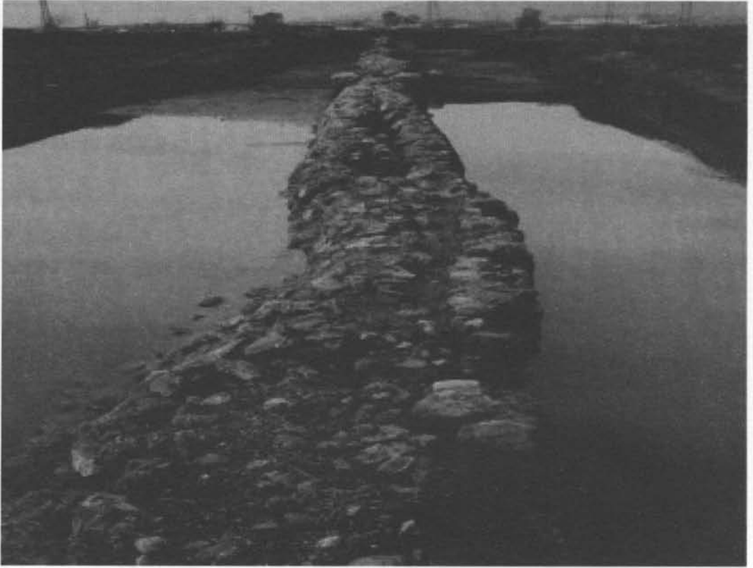
Foto 2.- Reptación e hidromorfia en el acueducto de Valdepuentes.
