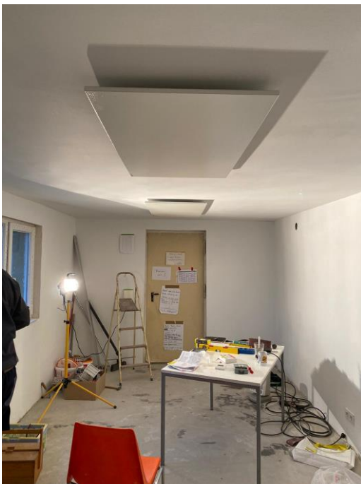
Clubhaus - Moderne Heizkörper
