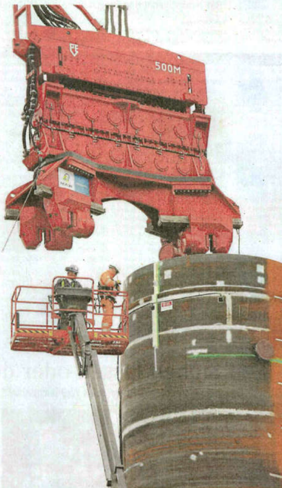
Der rote Vibrationshammer wird über den Kopf gestülpt und versetzt das Fundamentrohr in Schwingungen, wodurch es im Boden versinkt.
