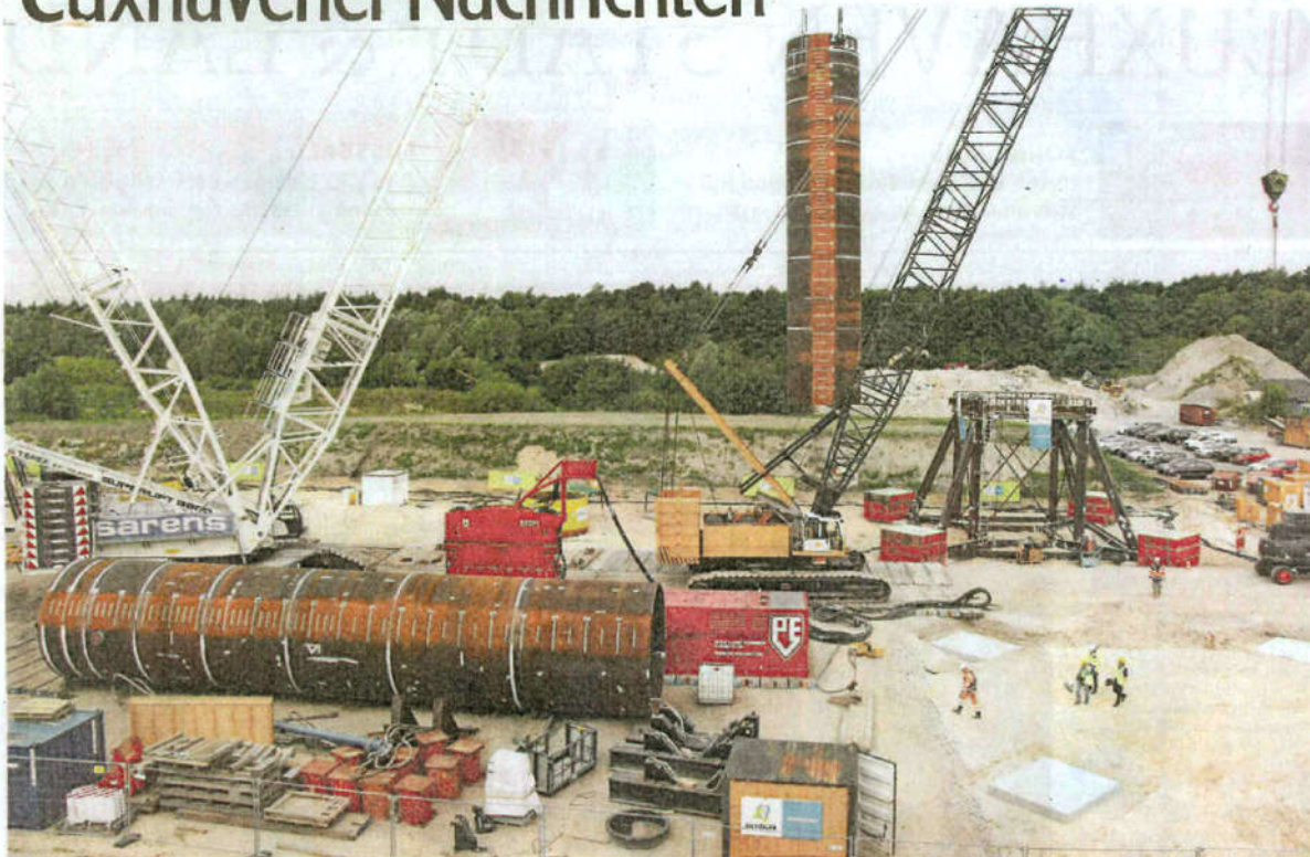
Ein Archivfoto aus dem Sommer 2014 zeigt die Dimension der Testanordnung in der Altenwalder Sandkuhle. Die Bodenstruktur ist dort identisch mit den Stellen in der Nordsee, an denen die Windparks errichtet werden. Die Branche schaut auch jetzt wieder auf das Altenwalder Testgelände, wo derzeit ein weiterentwickeltes Gründungsverfahren getestet wird. Fotos (3): Sassen
